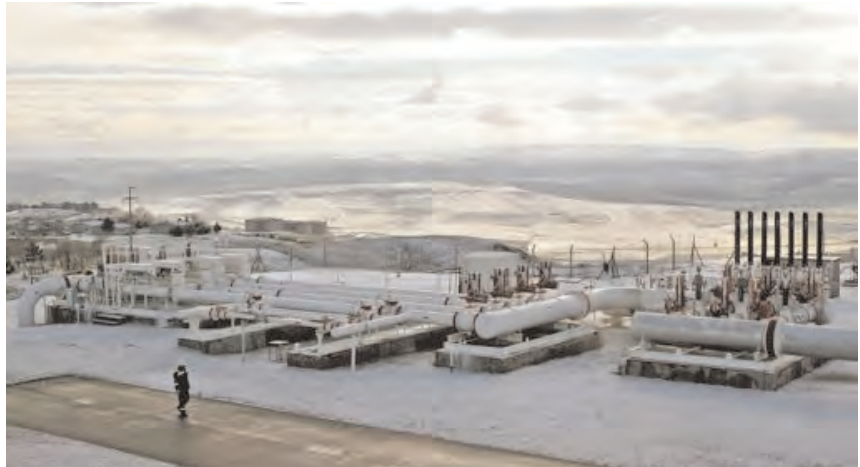
Un centre de contrôle de la Botas Petroleum and Pipeline Corporation, à 35 km à l'ouest d'Ankara, qui transporte le gaz naturel irakien à travers la Turquie, « terre de transit énergétique ».
