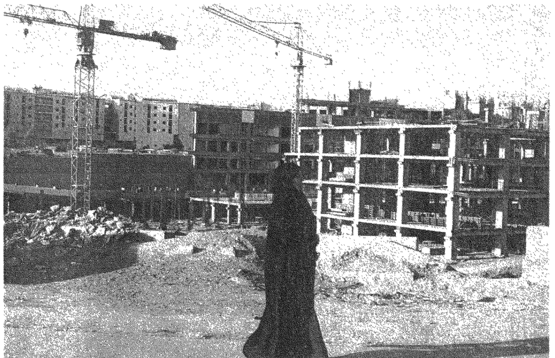
Chantiers de reconstruction des immeubles dévastés à Erbil, dans la région autonome du Kurdistan irakien, dans le nord de l'Irak, en avril 2009. GOUJON/ANDIA.FR
